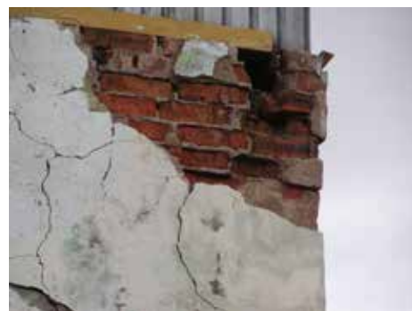
Ил. 4. Пример разрушения кладки в результате использования неподходящего поверхностного раствора на основе цемента. Фото с сайта http://pluskirpich.ru
