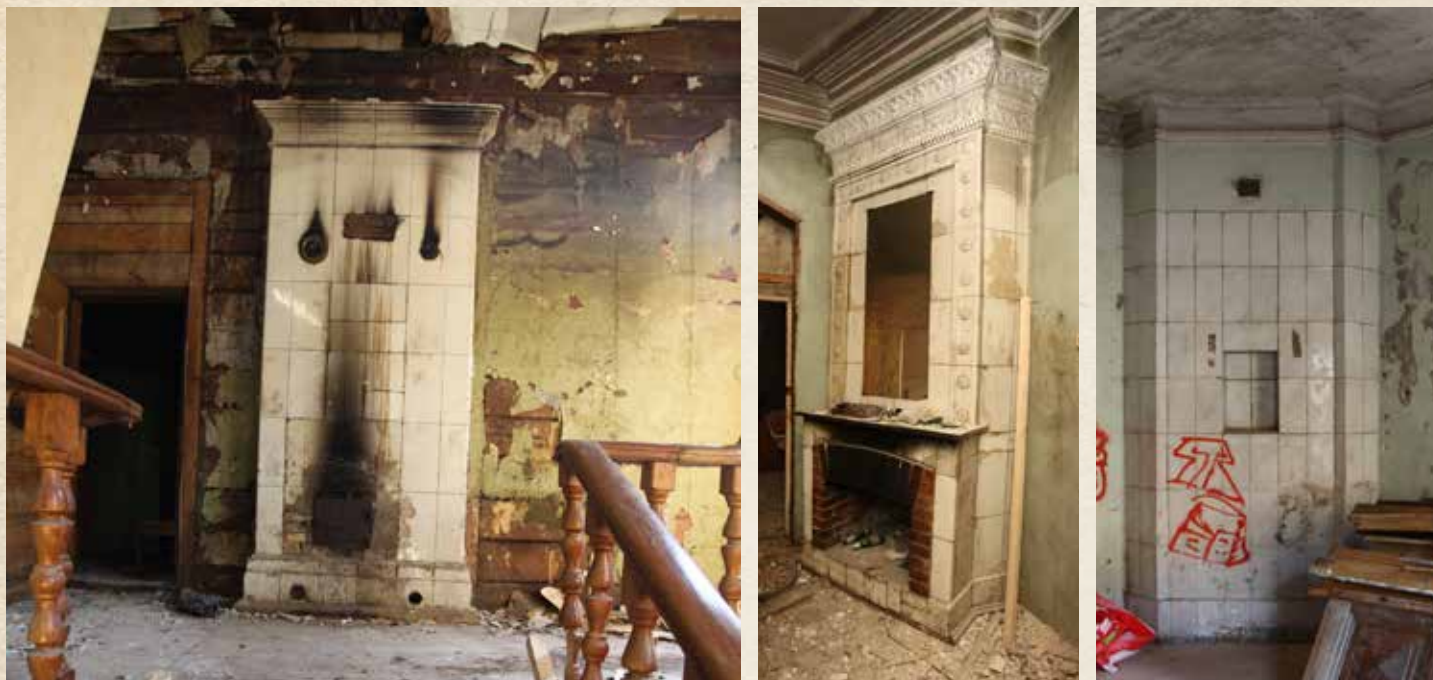
Ил. 3-4. Состояние печей и каминов до реставрации в усадьбе Талицы купцов Аигиных
